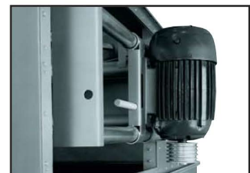
电动机检修门
