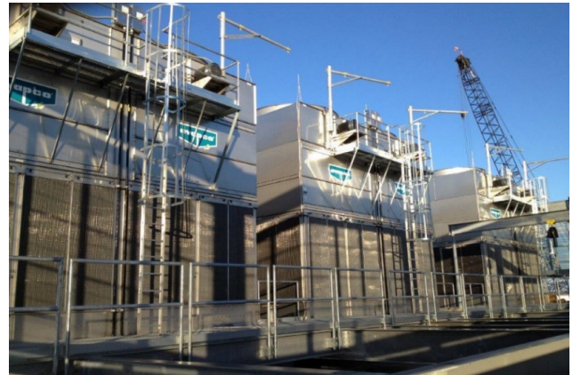
图2 — 不锈钢冷却塔
